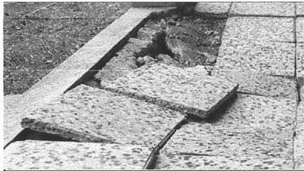
Foto1: cambio de piso por estar destruido.
